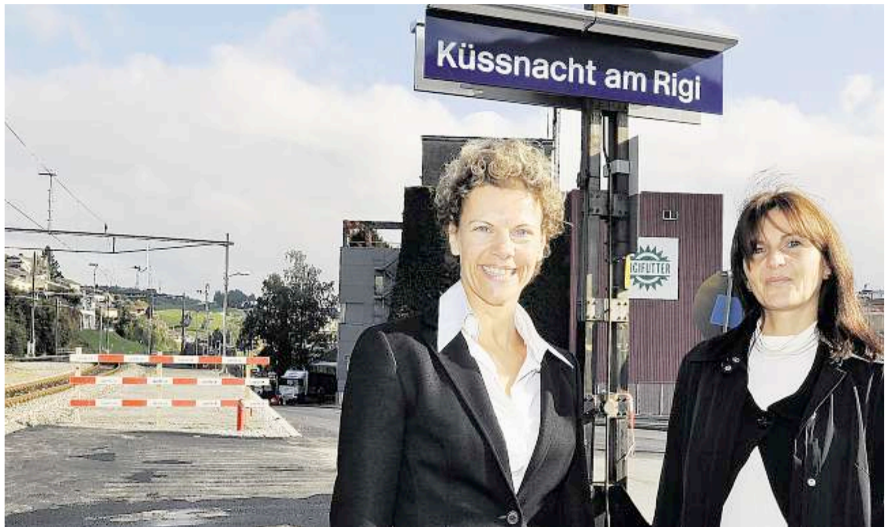
Schritt für Schritt zum neuen Bus- und SBB-Bahnhof: Bezirksrätin Carole Mayor (links) und Irena Gallati, Abteilungsleiterin Ressort Infrastruktur, freuen sich über den zügigen Bauverlauf an der Bahnhofstrasse. Bild Edith Meyer
